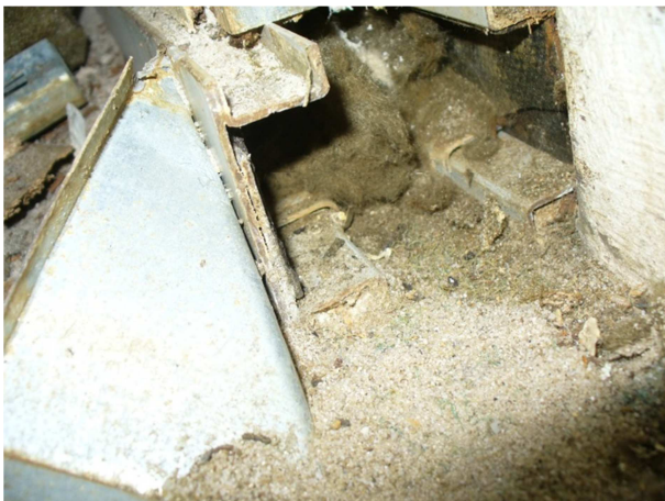
Detail 7 - Paneeltrennwand asbesthaltige Pappe im Sockel
