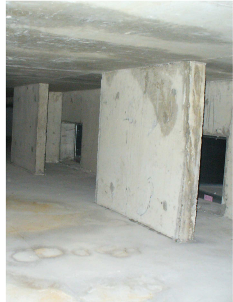
Staubabdruckprobe untere Ebene Lüftungsanlage KMF-belastet
