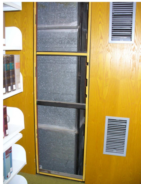
Installationsschacht keine Asbestverkleidung
