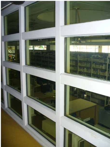
Verglaste Trennwand asbesthaltig
