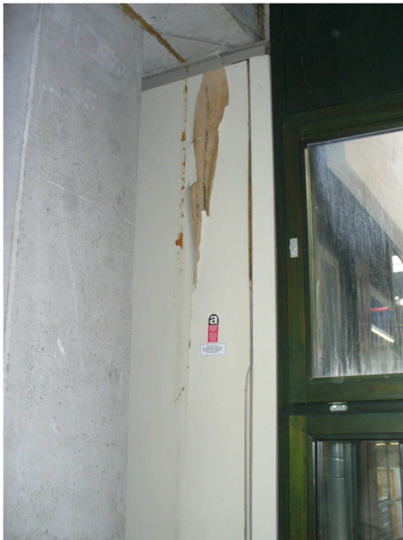
Detail 1 - Paneeltrennwand asbesthaltig
