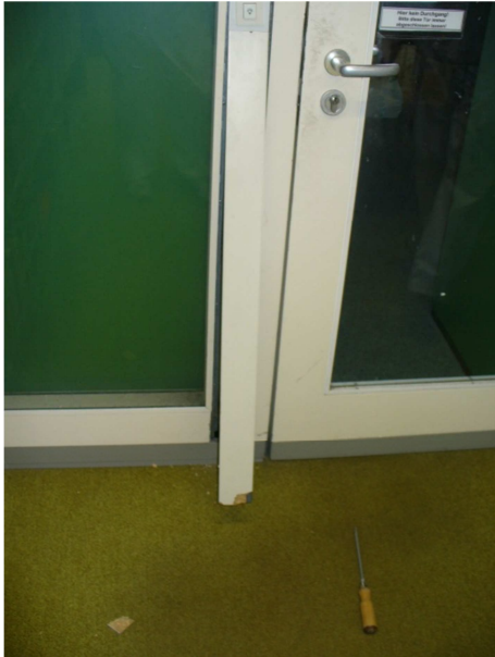
Trennwand ohne Asbestschnüre
