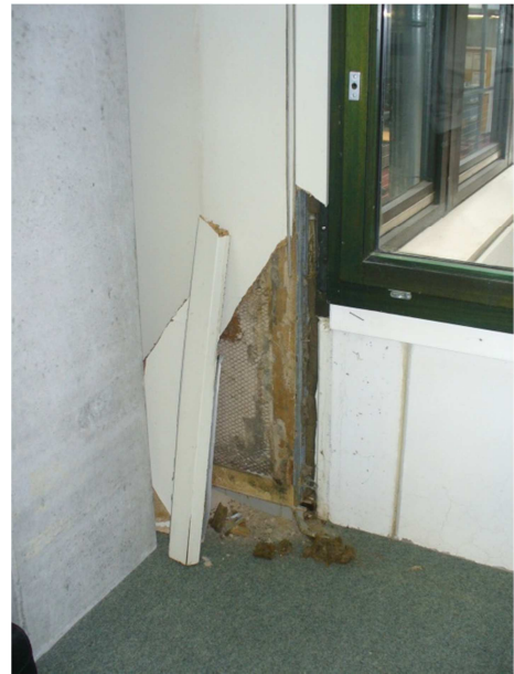
Detail 2 - Paneeltrennwand asbesthaltig
