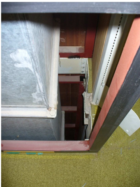
Installationsschacht keine Asbestverkleidung
