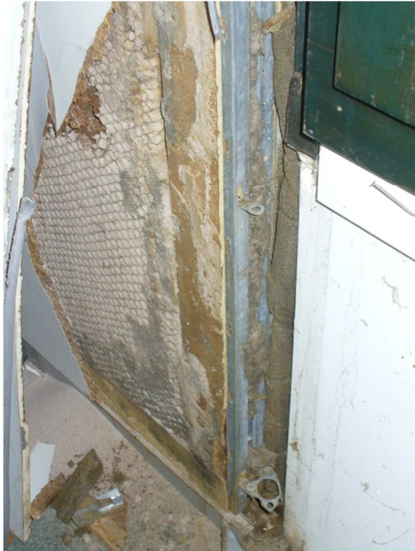
Detail 3 - Paneeltrennwand asbesthaltig
