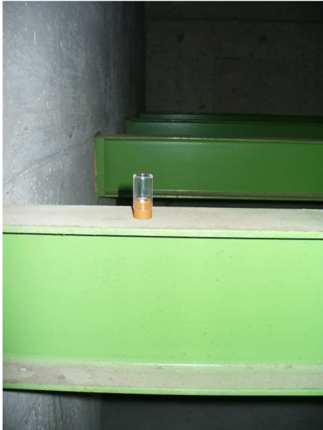
Staubabdruckprobe Stahlträger Eingangsebene Lüftungsanlage KMF-belastet
