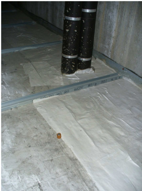
Staubabdruckprobe obere Ebene Lüftungsanlage KMF-belastet
