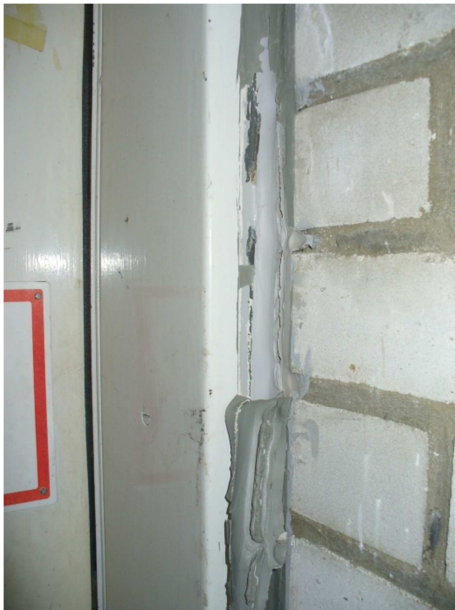
Dehnfuge asbestfrei, schwach PCB-haltig
