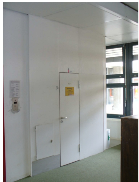
Trennwand geschlossen asbesthaltig
