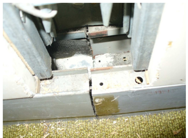
Sockel Trennwand ohne Asbestschnüre
