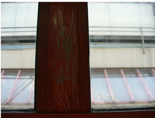
Außenfassade Ebene 3 Beschichtung Blei- und Cadmiumhaltig
