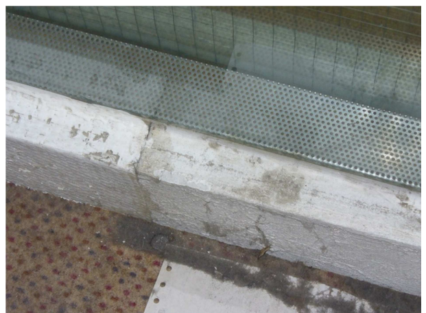
Detail 3 - Trennwand mit Doppelverglasung asbesthaltig
