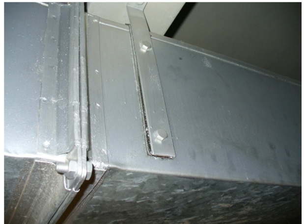
Flanschdichtung Lüftungskanal asbesthaltig
