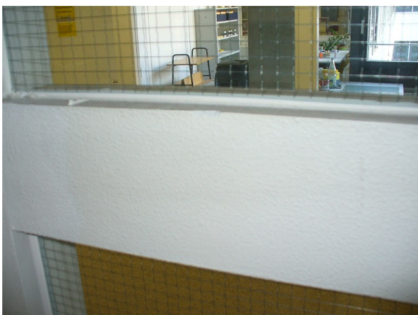
Detail 3 - Trennwand mit Einfachverglasung asbesthaltig
