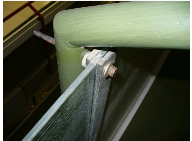
Dichtstreifen Verglasung Geländer asbestfrei
