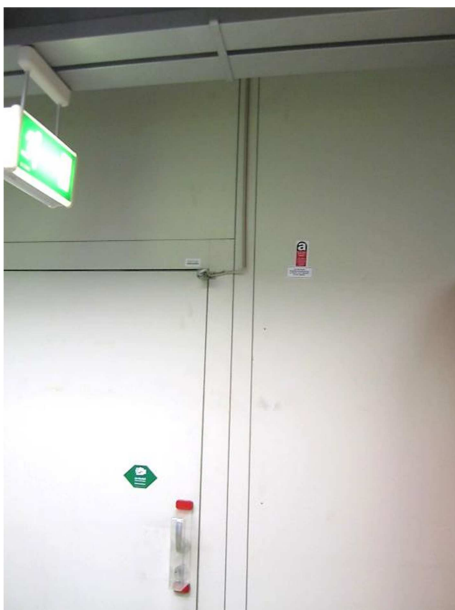
Paneeltrennwand geschlossen asbesthaltig
