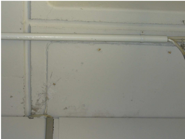
Verkleidung Deckenfeld Technischacht Asbestschnur und asbesthaltige Platte
