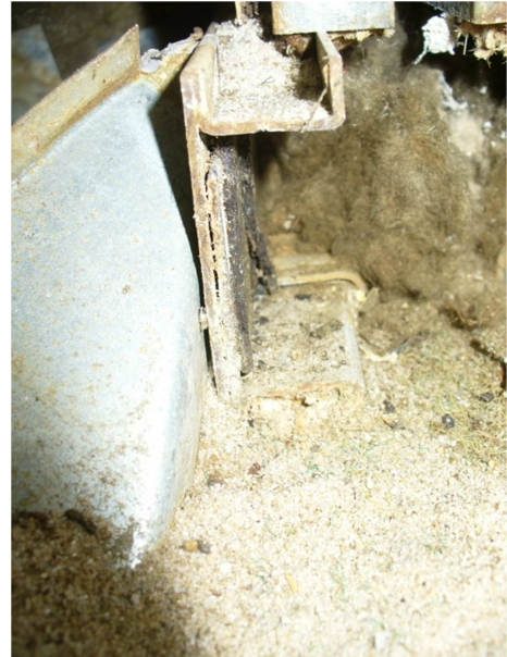
Detail 4 – Paneeltrennwand Sockel, asbesthaltige Pappe
