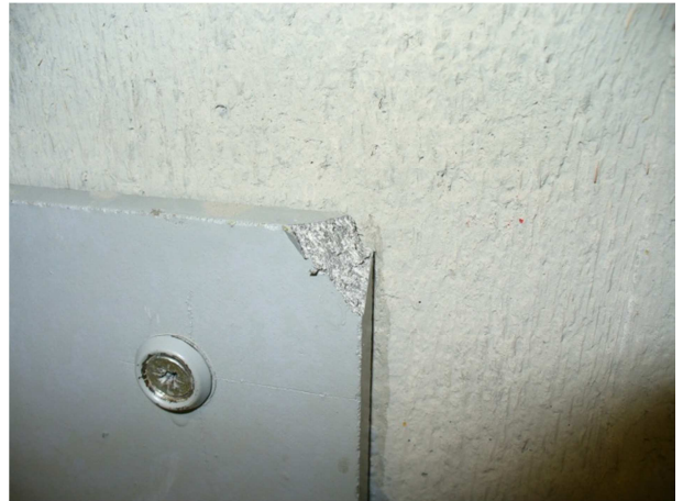
Asbestzementplatte vor Revisionsöffnung Technischacht
