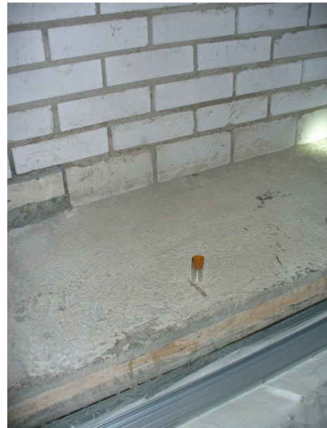
Staubabdruckprobe obere Ebene Lüftungsanlage KMF-belastet
