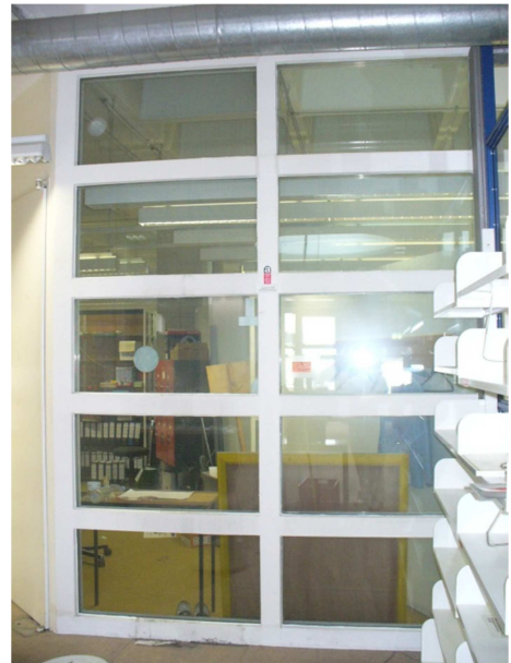
Verglaste Trennwand asbesthaltig
