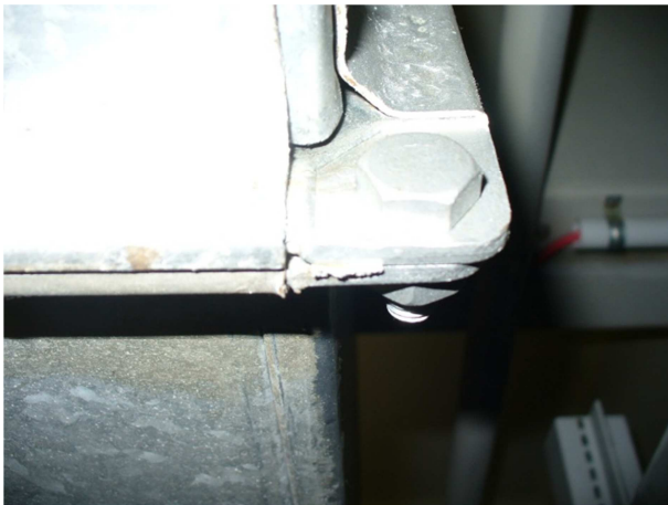
Flanschdichtung Lüftungskanal asbesthaltig
