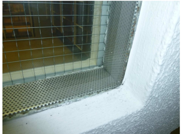
Detail 1 - Trennwand mit Doppelverglasung asbesthaltige Platten und Schnüre
