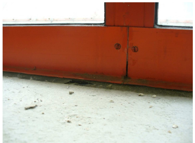
Brüstungsanschluss Außenfassade Ebene 3 PCB-haltige Fugenmasse
