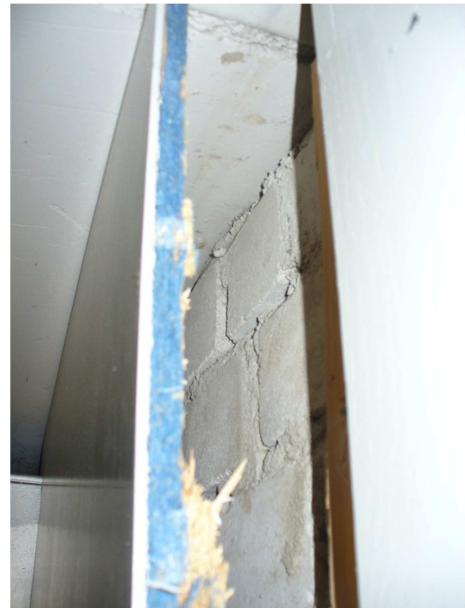
Deckenanschluss Technikschacht Ebene 4 Deckenverkleidung mit Asbestschnur
