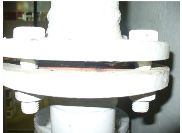
Flanschdichtungen Sprinklerleitung asbestfrei
