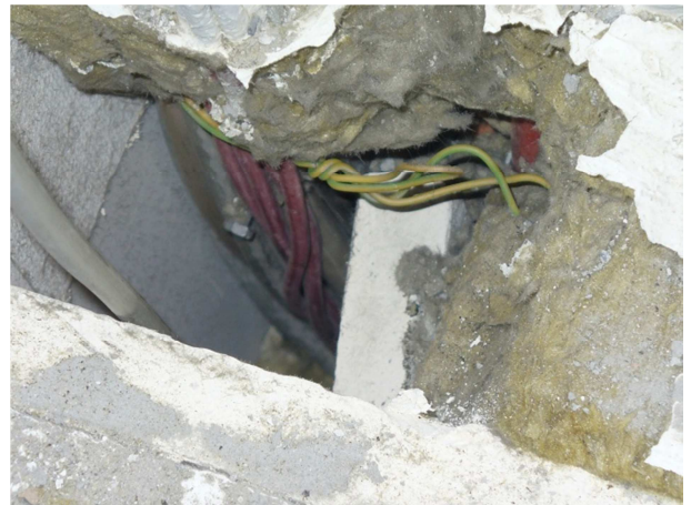
Installationsschacht KMF belastet
